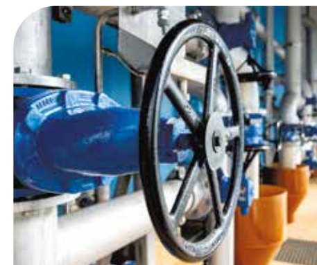
Blick ins Wasserwerk der Stadtwerke.
