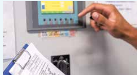
Überprüfung der Filteranlage.
