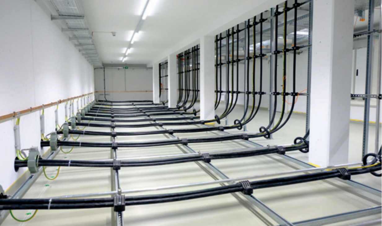
Übergabestation in der Anton-Dey-Straße: 11 Streckenkabel gehen ab an die 95 Trafostationen in Mühlheim, Dietesheim und Lämmerspiel.
